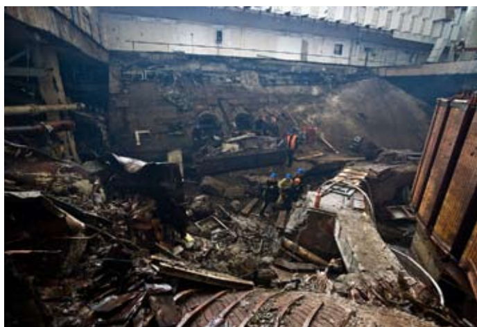
Затопление машинного зала полностью уничтожило сердце ГЭС на Енисее
